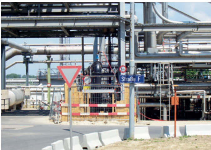
Eine Vielzahl anderer Transport- und Versorgungsleitungen in der Anlage erschwert häufig die Zugänglichkeit von zu sanierenden Löschwasserleitungen.
