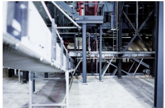
Die Fördertechnik schafft das Material zu den einzelnen Stationen.
