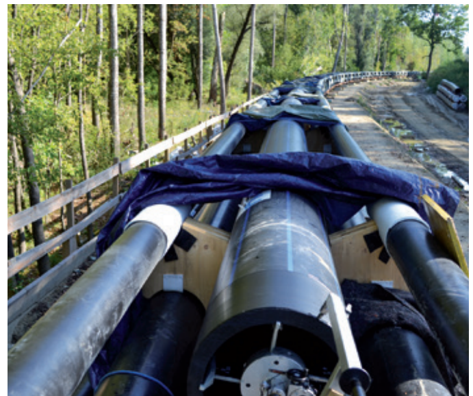
Der aus Stahl und Holz gefertigte Schlitten ermöglichte den Einzug der Rohrleitungen.
