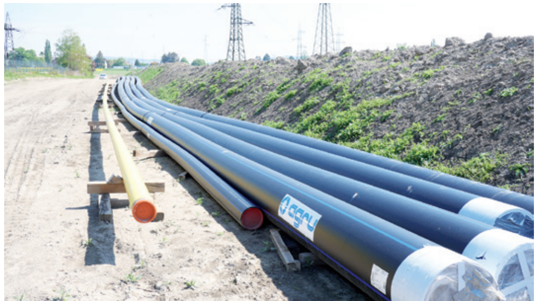
Die AGRULINE-Leitungen aus PE 100-RC in den Dimensionen d_a 560 mm stellen die Trinkwasserversorgung an beiden Ufern der Donau sicher.
