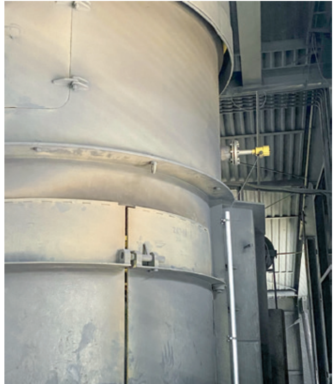
Die Bedingungen rund um den Schachtofen sind rau, die Sensoren von VEGA lassen sich jedoch weder von Staub noch von den hohen Temperaturen beeindrucken.
