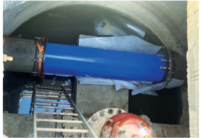
Auch vorhandene Schächte können als Zugangspunkte für die Sanierung mit Primus Line® genutzt werden.
